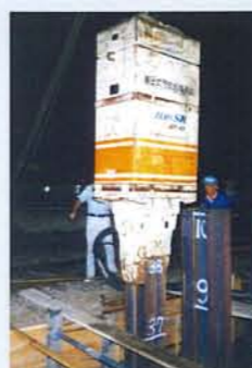
杭規格：H350×350 (L=38.0m) 発注：長野電鉄 工事名：松代駅構内雨水排水路新設工事
