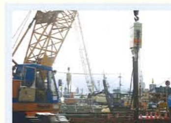
矢板規格：SP-III型 (L=16m) 発注：JR東日本 工事名：柳原橋内新設工事
