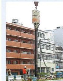
杭規格：H300×300 (L=28.5m) 発注：広島市 工事名：明治橋仮歩道橋設置工事
